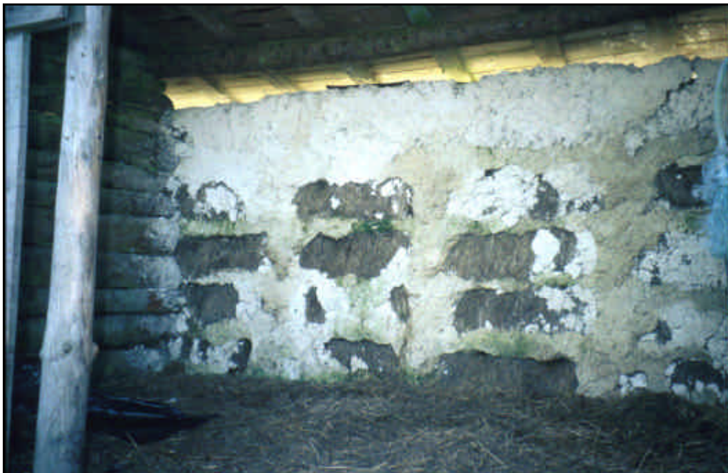
Billede 21 - Ballerne består bla. af lyng og græs. De er lagt med kalk-mørtel som fugemasse. Til venstre ses en beklædning af gavl-indervæggen med planker 28
