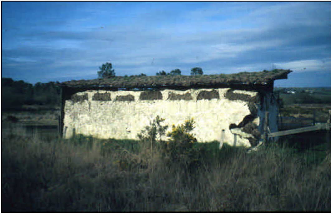
Billede 20 - Bygget 1987. Kalkpuds ind- og udvendigt. Utilstrækkeligt tagudhæng har medført vandskader i øverste lag baller 27
