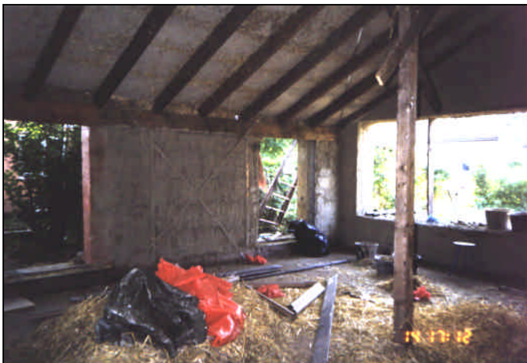
Billede 14 - væggen pudset en gang indvendigt. Loftet ligeledes pudset 19
